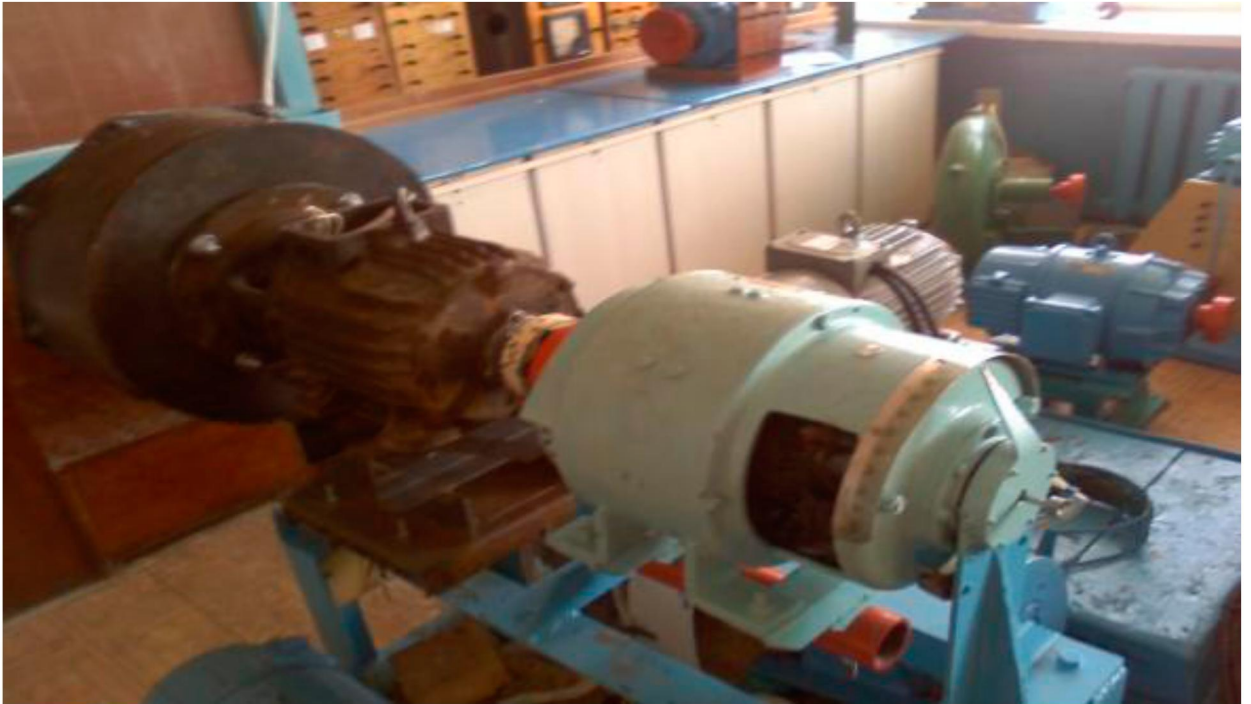
Рисунок 3.26 – Внешний вид лабораторной установки (вид со стороны балансирующей машины)
